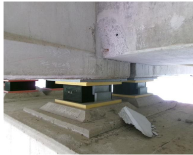
② 가로보 박락 및 철근노출 - 진전 여부확인s8
