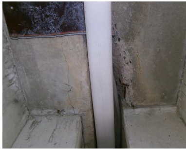
① 바닥판하면 박락 및 철근노출 - 진전 여부확인s4
